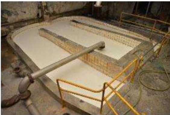
【照片 2-4-5】儲漿槽—保持循環狀態
